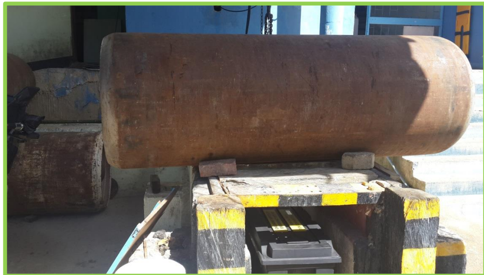
Figura 19. Desinfección por cloro gaseoso
