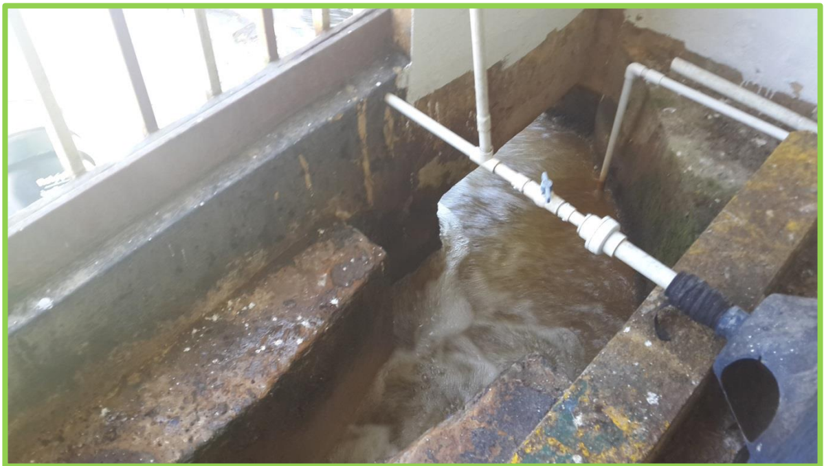
Figura 12 Caneleta parshall planta nueva
