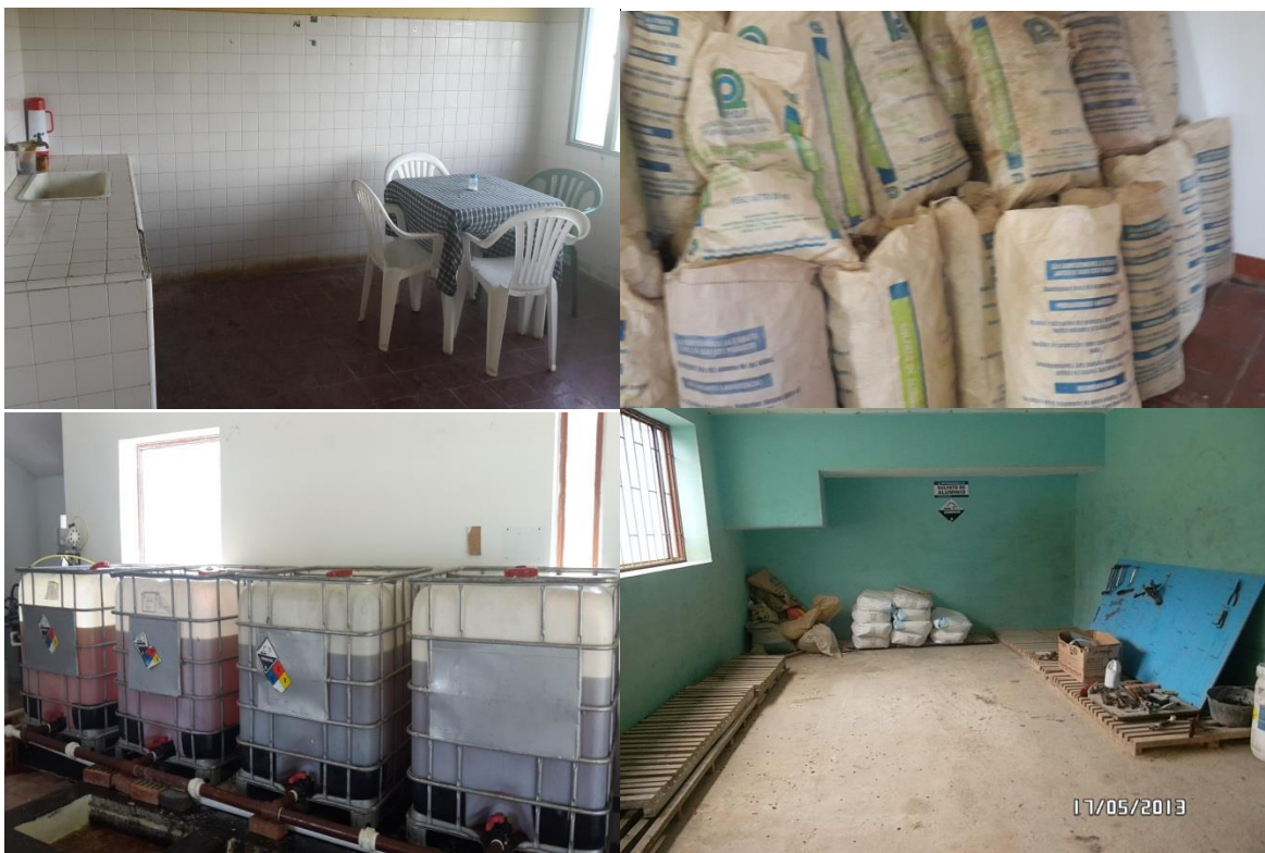
Figura 25. Instalaciones Complementarias PTAP
